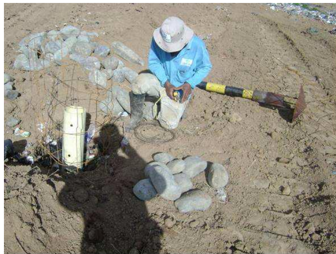
Figura 7 Chimeneas de extracción (CNPML, 2008)
