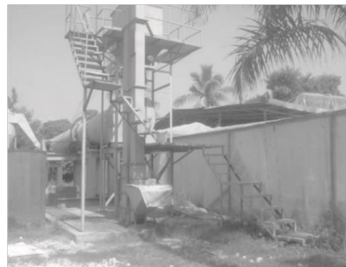
Fotografía 8. Horno para la calcinación de residuos industriales. Ecomat
