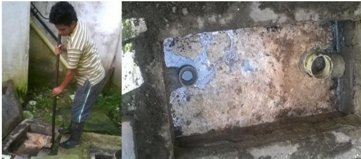
Ilustración 7. Limpieza Trampa de Grasas, Vivienda Villa Camila, Vereda San Juan de Carolina.
