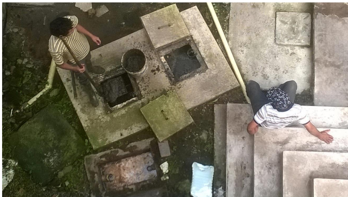
Ilustración 6. Extracción de Natas y Sólidos, Vivienda Villa Camila, Vereda San Juan de Carolina.
