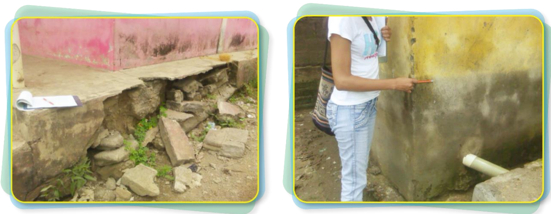
Figura 8. Daños en pisos y medición en la altura de la lámina de agua.
