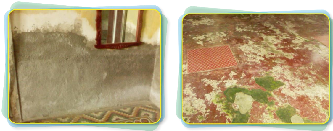
Figura 7. Daños en paredes y pisos de las viviendas.
