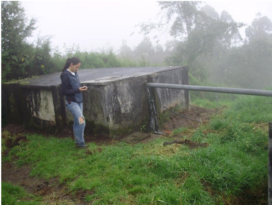
Fotografía 7 Tanque Vereda Alto del Guamo, Manizales
