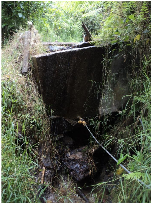
Fotografía 5 Tanque de Almacenamiento Vereda Agua Bonita, Manizales
