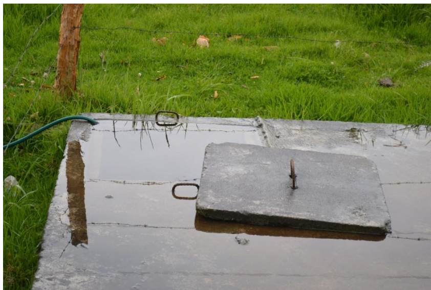
Fotografía 2 Tanque de Almacenamiento Vereda Las Palomas Manizales
