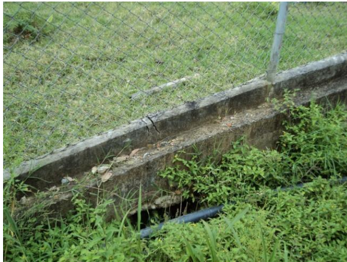
Fotografía 4 PTAP Vereda Maracas, Manizales
