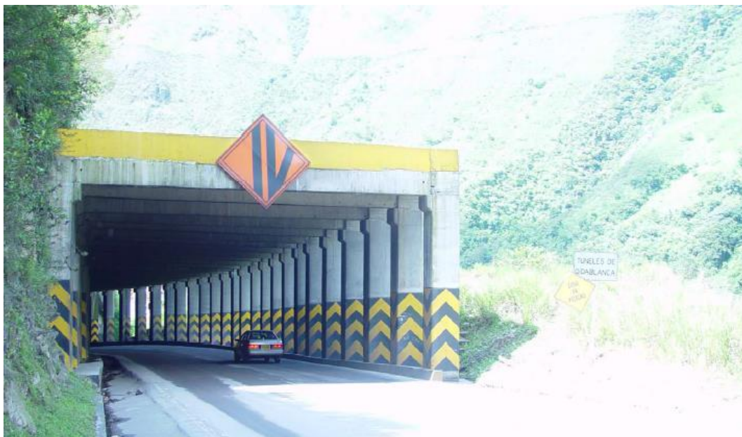
Figura 42 Cubierta de protección para mitigar impacto de los bloques, Tuneles de Quebrada Blanca (Suarez Díaz, Deslizamientos y estabilidad de taludes en zonas tropicales , 1.998)
