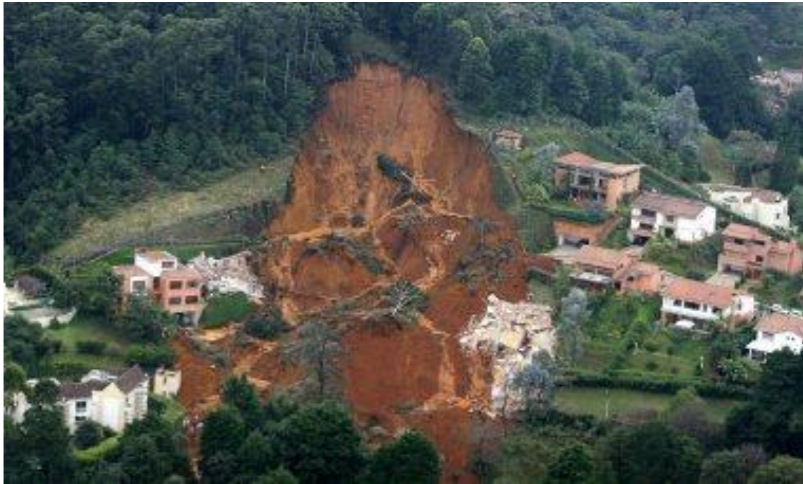
Figura 11 Deslizamiento Barrio El Poblado, Medellín – Noviembre 16 de 2.008 (Zuluaga, 2008)
