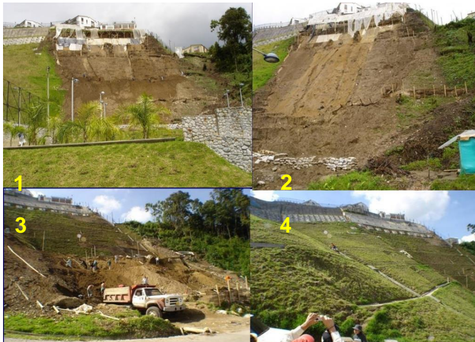
Figura 86 Secuencia de la construcción de medidas estructurales para la mitigación del riesgo por deslizamiento después de la tragedia (POSADA, 2012)
