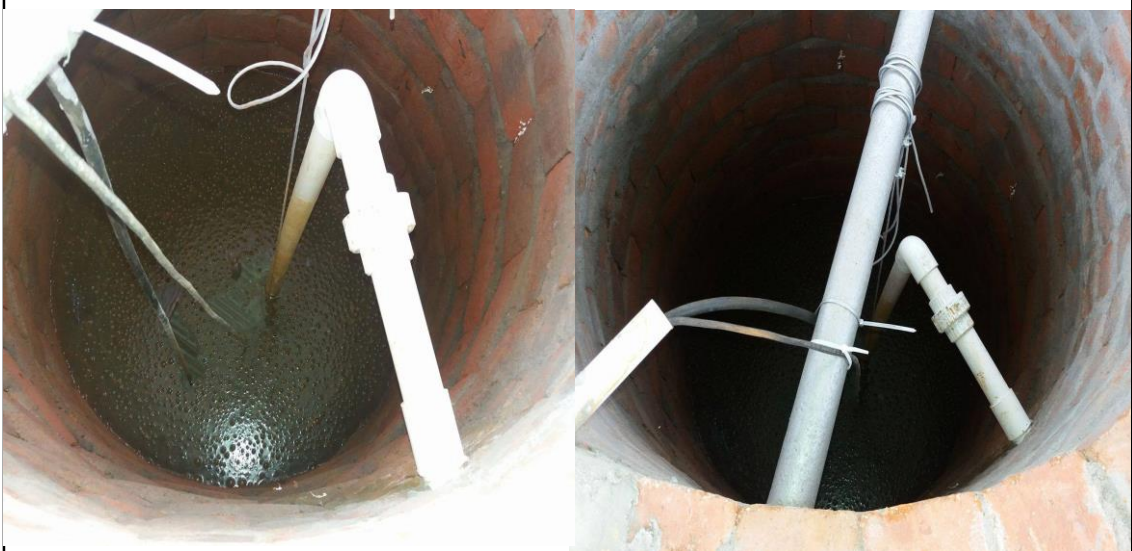
Figura 23. Cuenta con un soporte metálico incrustado entre las paredes con el fin de sostener la motobomba y las instalaciones eléctricas del sistema.
