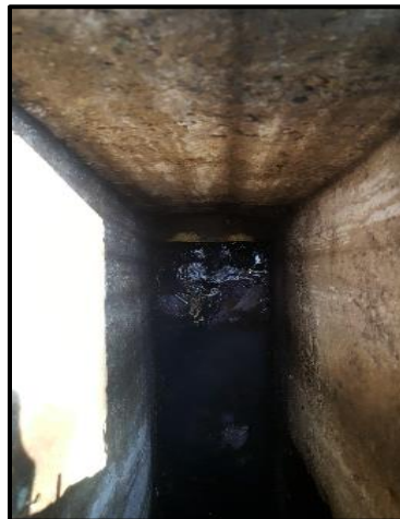
Ilustración 43. Canal de rebose, afluente STARD (punto 1).
