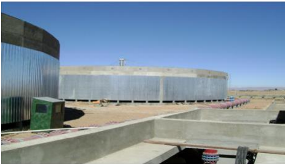
Imagen 10. Filtros Percoladores de la PTAR Puchukollo.
