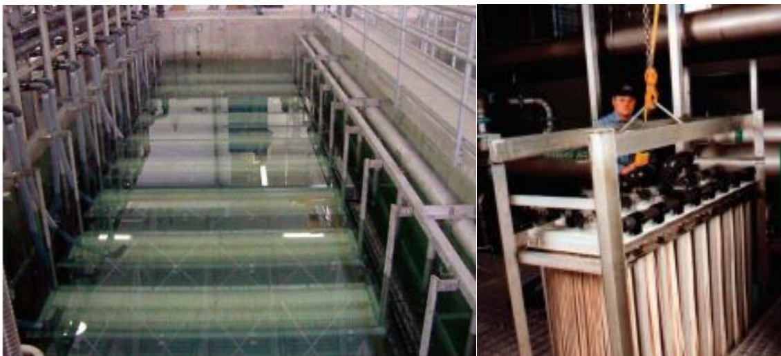
Imagen 18. Reactor Biológico de Membrana.
