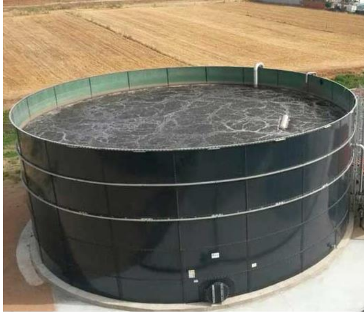
Imagen 11. Reactor Biológico Secuencial (SBR).
