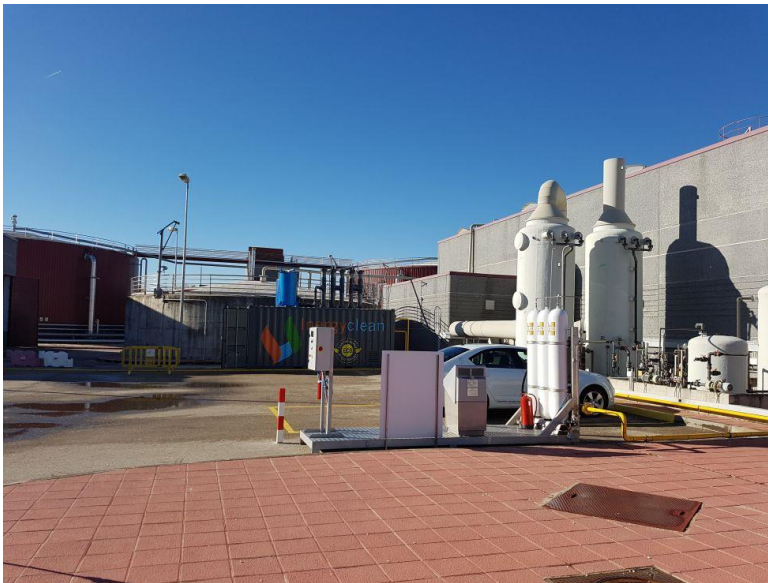
Imagen 19. Instalaciones de la EDAR de Guadalajara.
