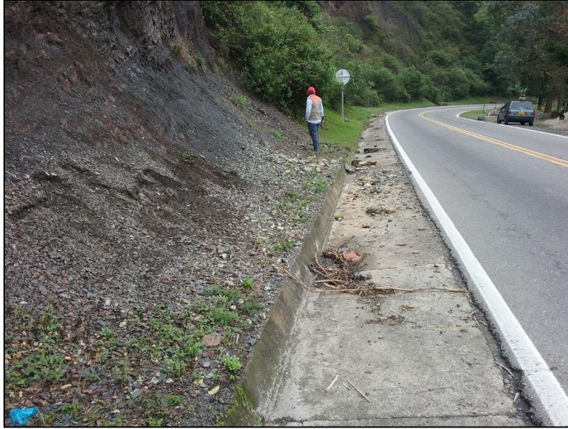
Fotografía 44. Material desprendido en el sitio crítico 16. (Fuente: elaboración propia)
