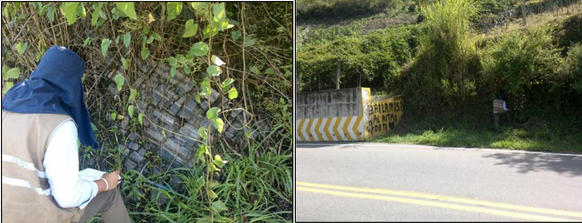
Fotografía 21. Detalle de los afloramientos de la Fm. Colón Mito Juan y relleno antrópico en el sitio crítico 8. (Fuente: Elaboración propia).
