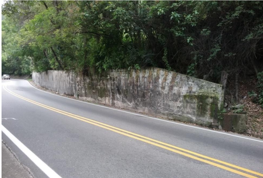
Fotografía 26. Aspecto del muro en el sitio crítico 11. (Fuente elaboración propia).
