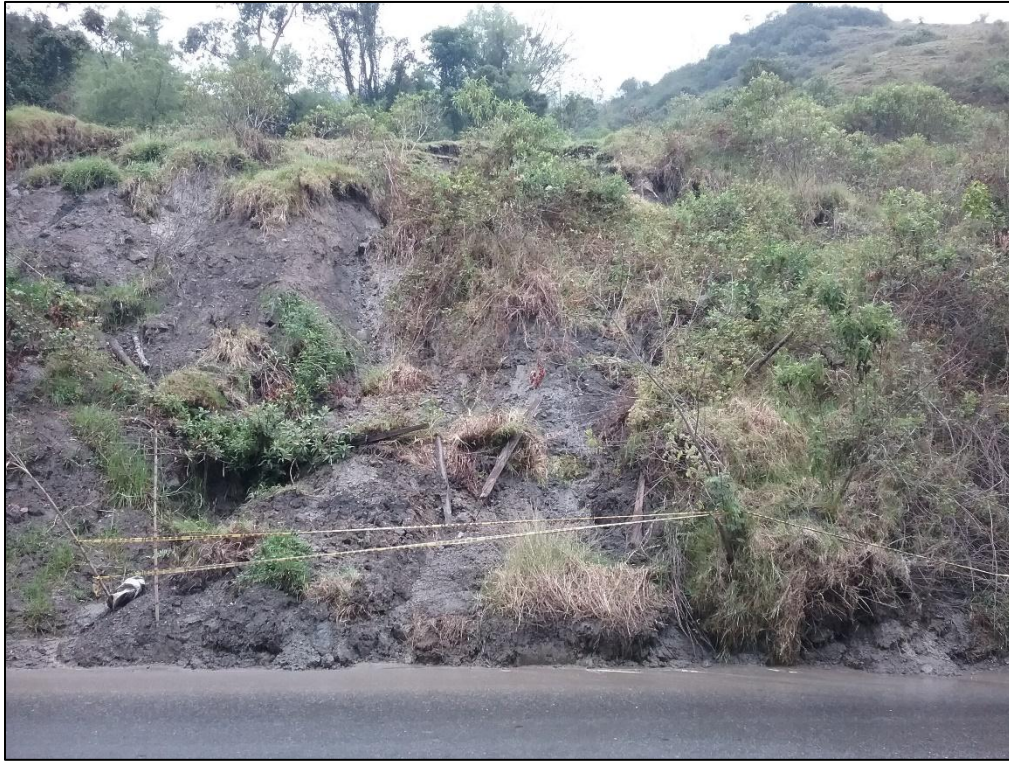
Fotografía 48. Material desprendido en la vía del sitio crítico 17. (Fuente: elaboración propia)
