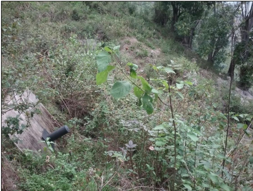
Fotografía 30. Anclajes en coronación (Fuente elaboración propia)
