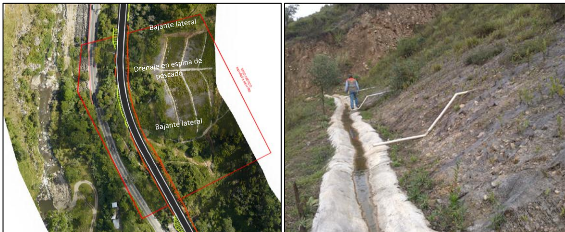
Fotografía 13. Detalle del sistema de drenaje observado en el sitio crítico 5 (Fuente: Elaboración propia).
