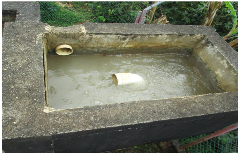
Ilustración 22 Tanque de entrada de agua a la PTAP
