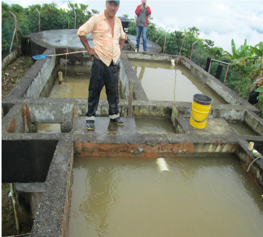
Ilustración 23 Panorama general de unidades que componen PTAP
