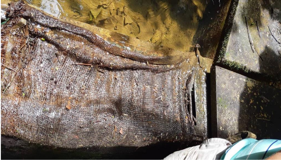
Ilustración 16 Rejilla de captación bocatoma 3.
