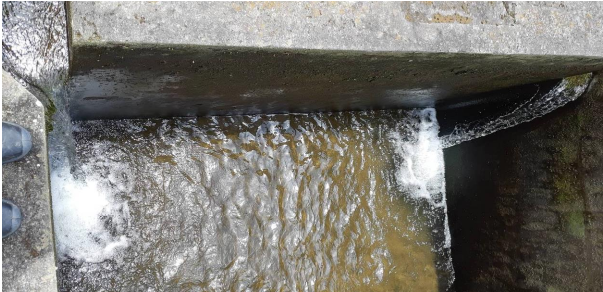
Ilustración 20 Presencia de lama en paredes interiores del tanque de salida.
