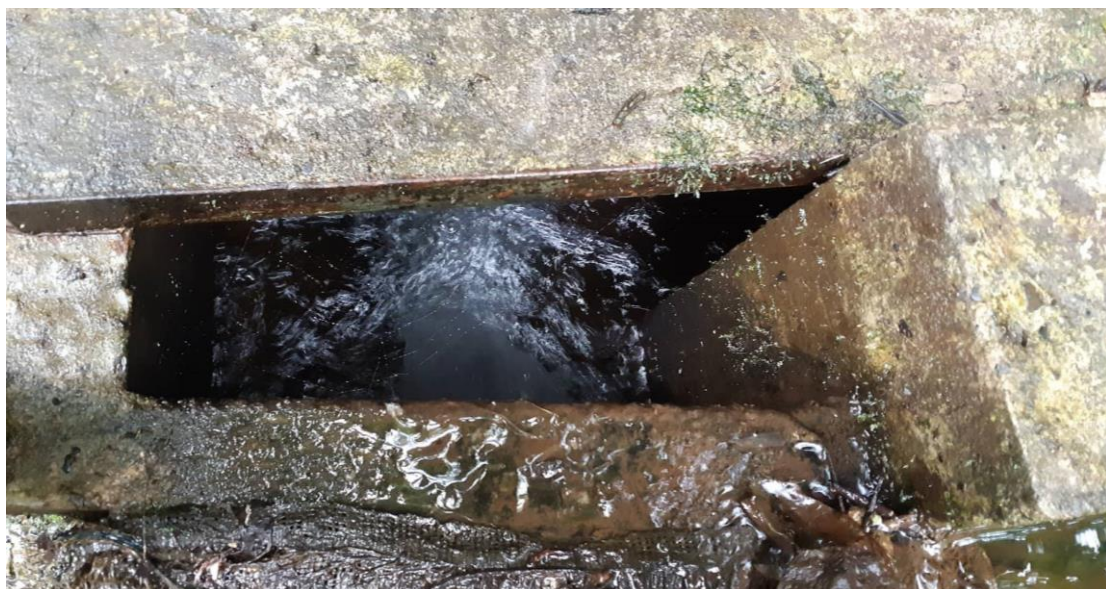
Ilustración 11 Compuerta caja de derivación -Bocatoma 1.
