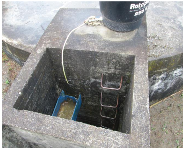
Ilustración 26 Cámara de desinfección.
