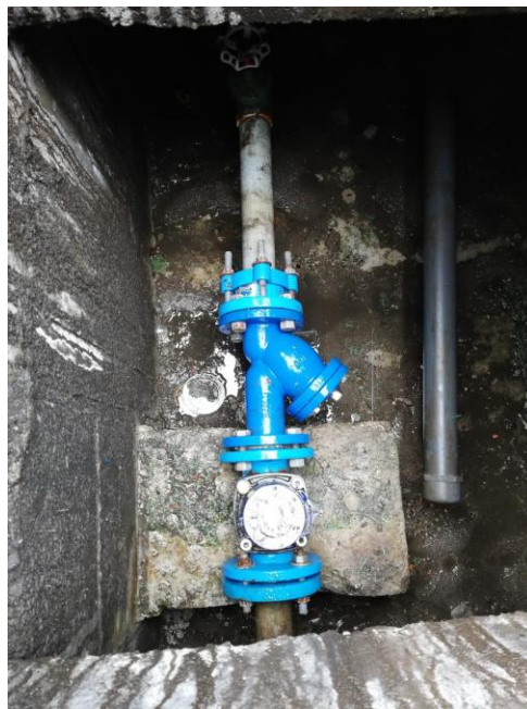
Fig. 3 Contador UCM con fuga
