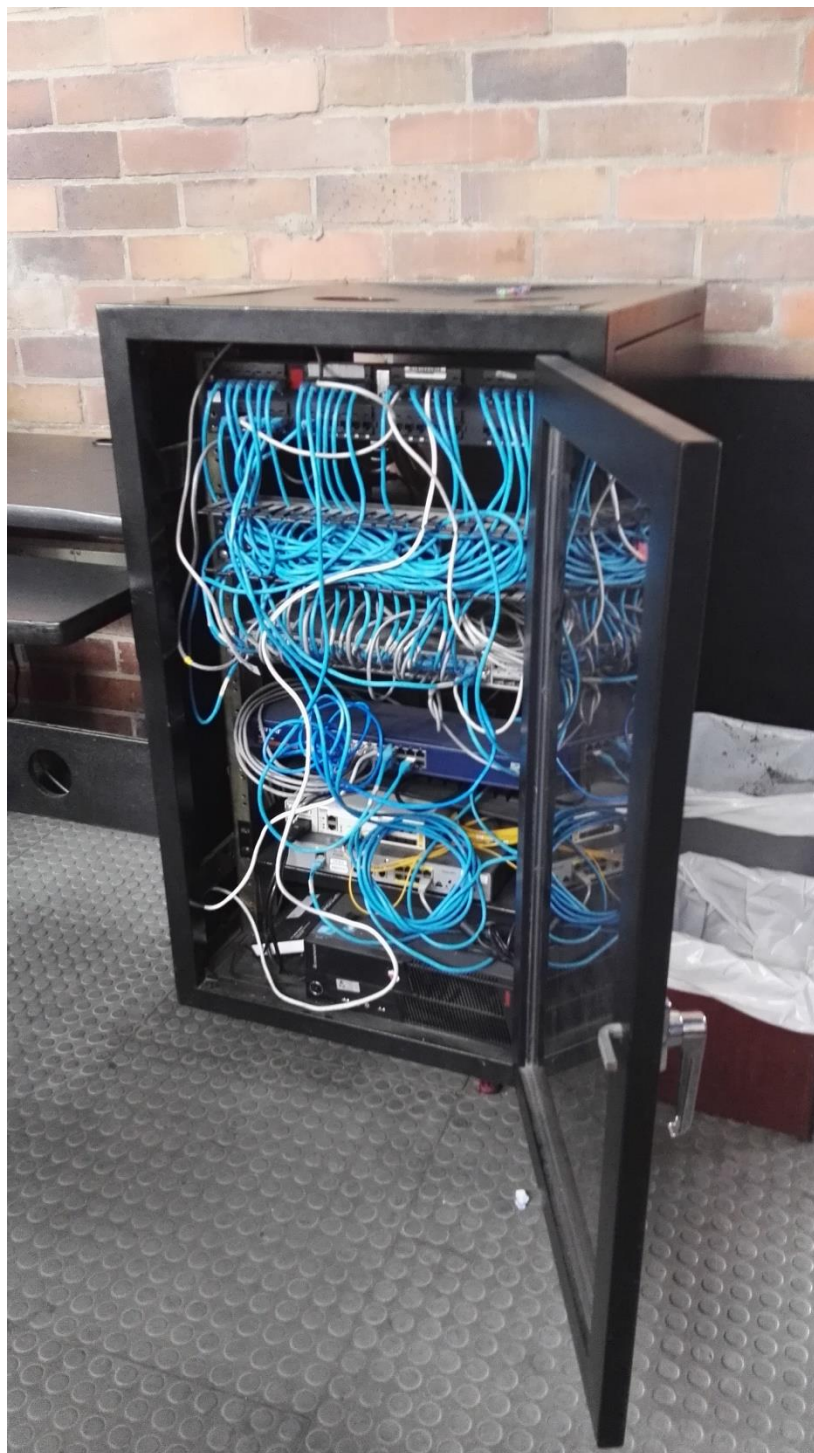
Imagen Equipos de conexión en red de Área Local del Colegio Miravalle
