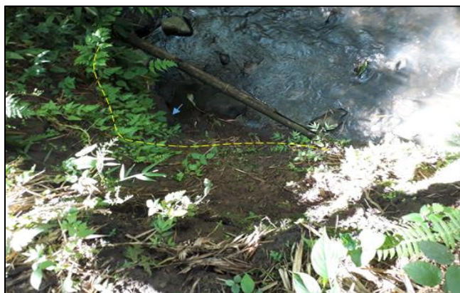
Figura 20. Socavación en la Quebrada La Silenciosa E: 1139422, N: 1001621:
