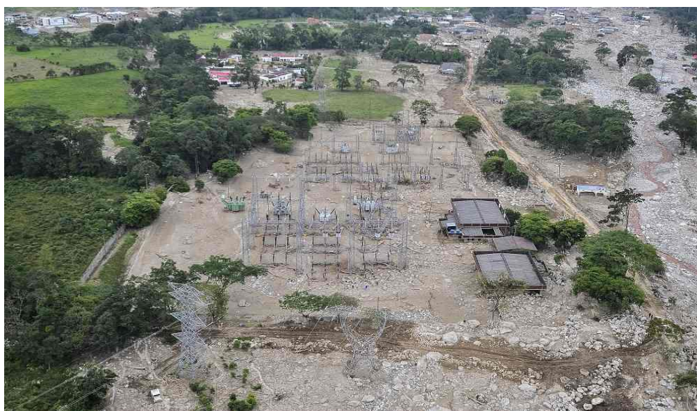
Imagen 5. Subestación Eléctrica JUNIN
