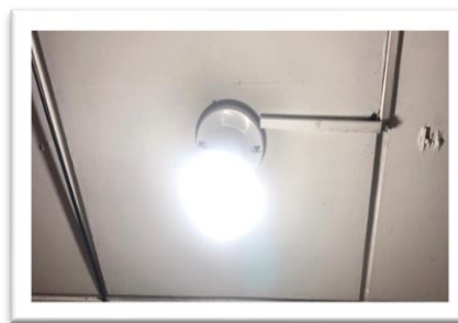
Figura 9. Luminaria del pasillo 3
