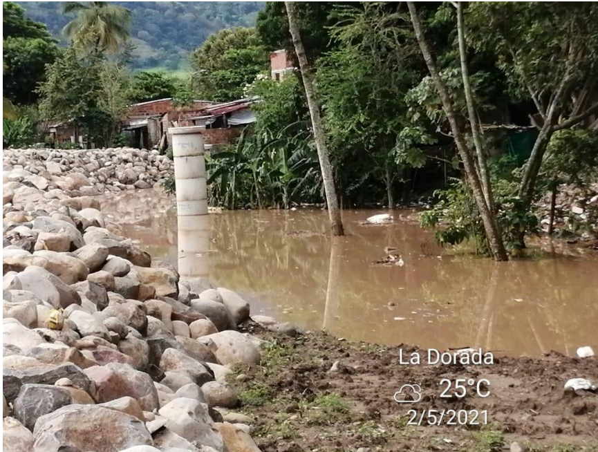
Imagen 52. Inundaciones generadas en la parte interna del Rip Rap durante la construcción del mismo. "Ola Invernal 02 mayo de 2021".
