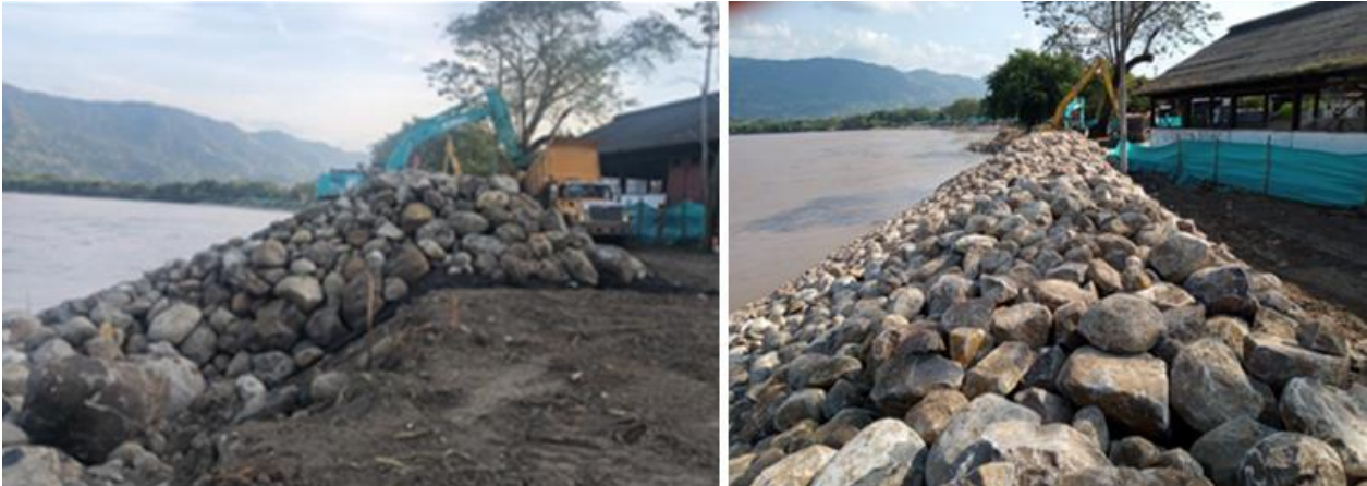
Imagen 61. Sección típica de la construcción de la obra de mitigación de riesgo de socavación, se observa la base, pendiente y corona del enrocado sobre un talud perfilado. Fuente: Elaboración propia-Gobernación de Caldas-INGECON.
