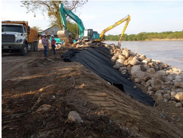
Imagen 59. Proceso de instalación de geotextil en la construcción de la obra de mitigación de riesgo de socavación Rip-Rap. Fuente Elaboración Propia-Gobernación de Caldas-INGECON.
