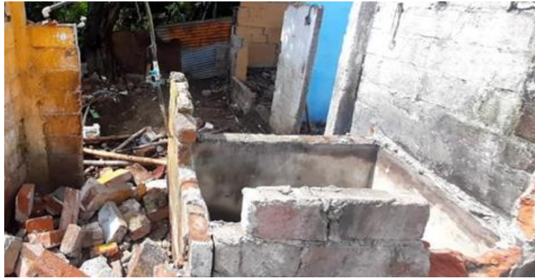
Imagen 67. Vivienda del señor Ana Beatriz Hernández Marín, sobre la faja de protección ambiental del Río Magdalena, fue demolida y reubicada en mejores condiciones de vida. Fuente: Gobernación de Caldas-Alcaldía de La Dorada, Construcción obra de mitigación.
