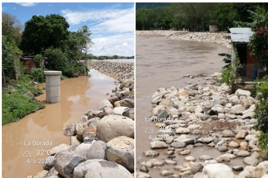
Imagen 73. Suspensión de obras de construcción obra de mitigación de socavación, temporadas de lluvias en los meses de marzo y mayo de 2021.
