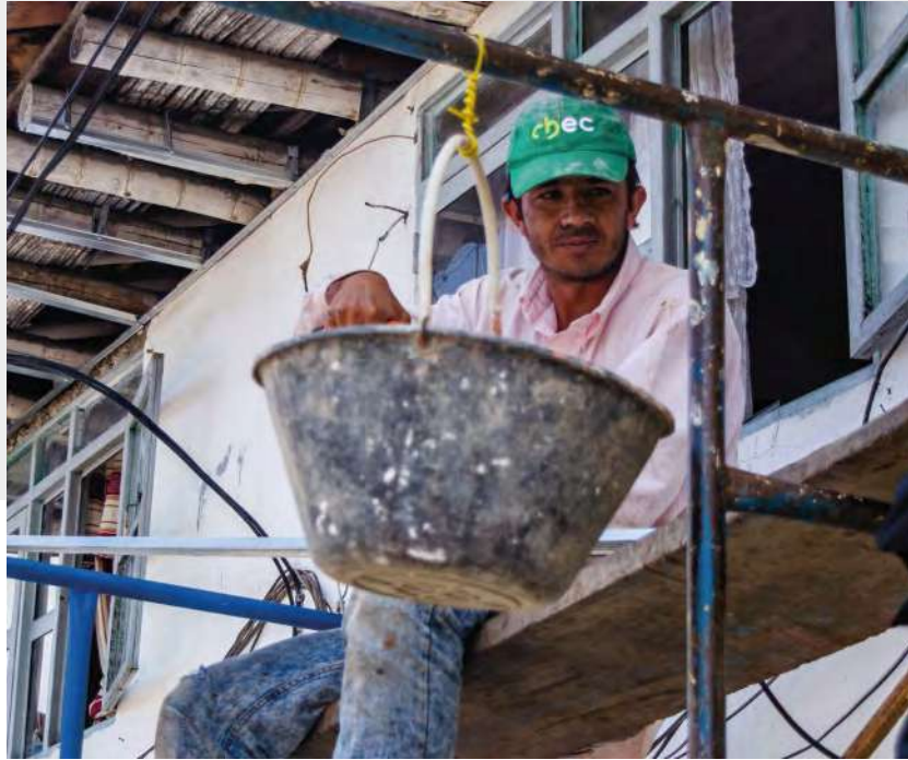
Figura 14. Luis Ansisa mientras trabaja en alturas, “(...) en una construcción de Salamina en donde realiza trabajos de reparación locativa y de soldadura. Manifiesta que gracias a la energía eléctrica puede desarrollar su trabajo”.
