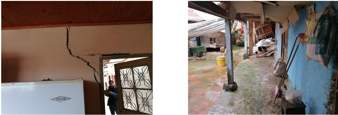
Fotografía 1 Viviendas agrietadas en el área de estudio
