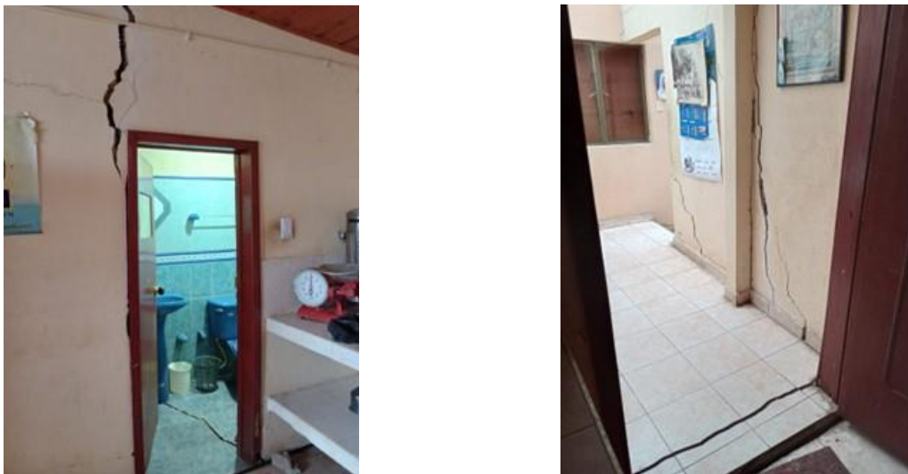
Fotografía 2 Viviendas agrietadas en el área de estudio
