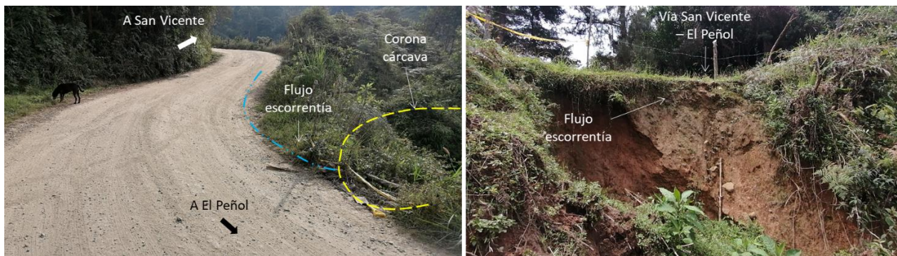
Figura 33. Descarga agua lluvia y escorrentía de la vía al proceso erosivo.
