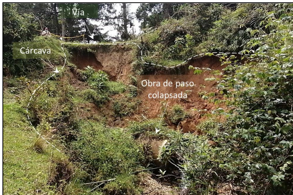
Figura 5. Cárcava en obra de paso de fuente hídrica Vereda Piedra Gorda.
