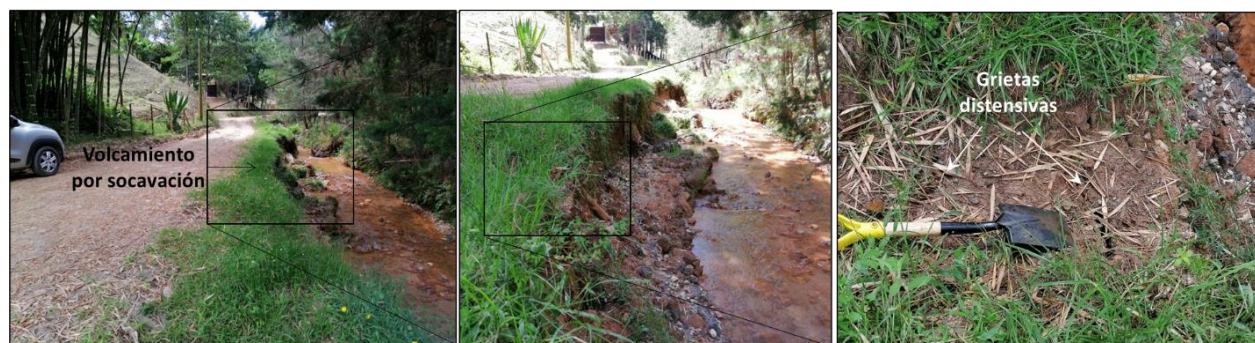
Figura 14. Proceso de socavación de la quebrada Guacirú.
