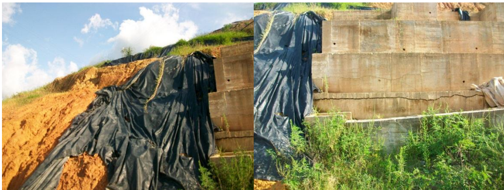
Imagen No.5 Obras de estabilidad inconclusas parte baja del barrio el Bosque
