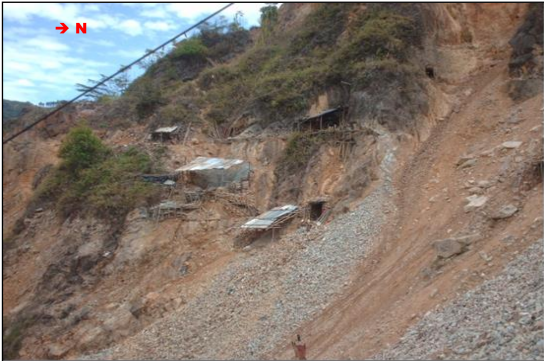
Fotografía 4. Movimientos (3) activos de depósitos antrópicos de estériles. Fuente propia. 2012
