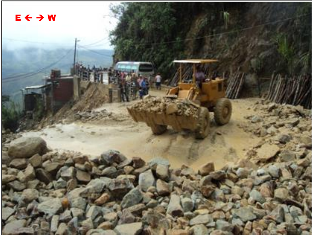
Fotografía 11. Bloqueo por caída de piedra. Fuente: Cuerpo de Bomberos Voluntarios de Marmato, 2012.
