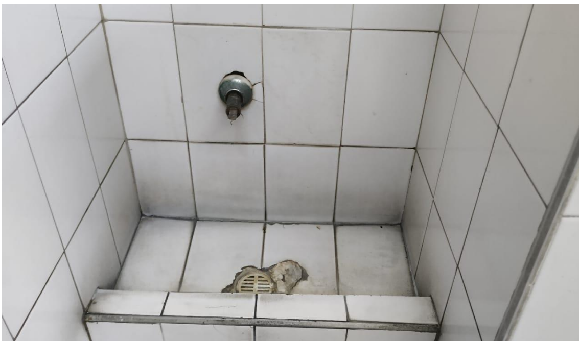
Figura 14. Llave para lavado de orinal en mal estado Fuente: Propia
