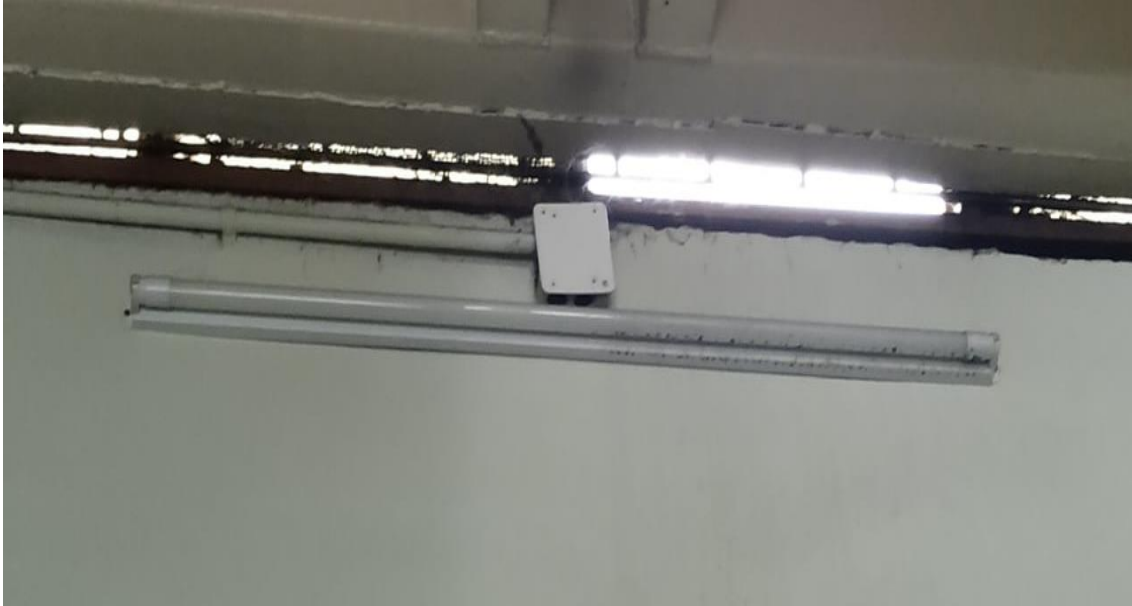
Figura 12. Luminaria del piso 4
