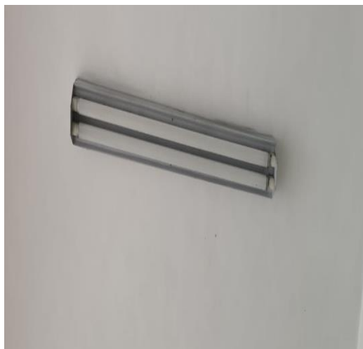
Figura 11. Luminaria del piso 3 Fuente: Propia
