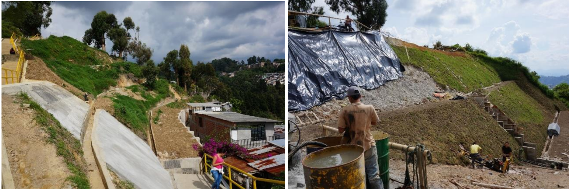
Figura 21. Barrio Pesia, falencias de obras de intervención.
