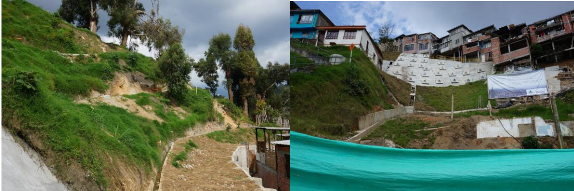
Figura 6. Obras de tratamiento geotécnico - pantallas ancladas activas, zanjas recolectoras horizontales y verticales con disipadores de energía, empradizado, perfilado y Qeison, parte alta barrio El Persia.
