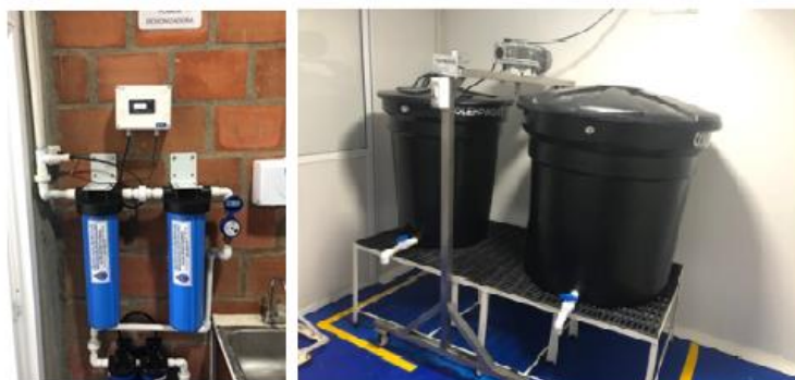
Ilustración 11. Planta de tratamiento de agua.
