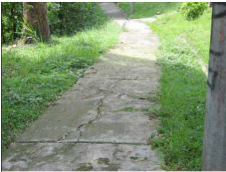
Figura 31. Agrietamientos en andenes en la urbanización Loyola.
