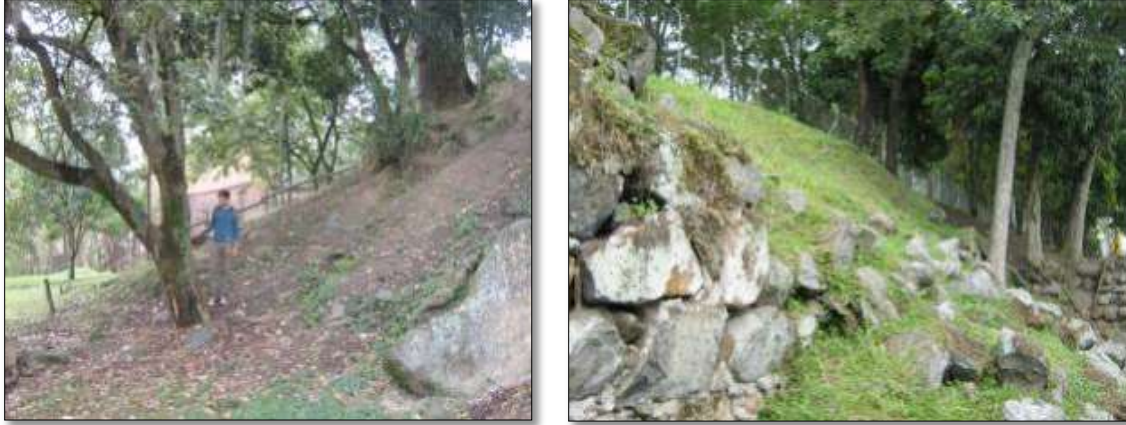
Figura 32. Unidad deportiva Miraflores presenta árboles inclinados y muro fallado.
