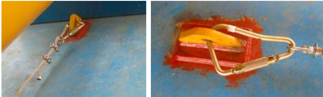
Fig. 4 – 5. Anclajes para trabajos en alturas en Carro-grúa, Anclajes en soldadura , agosto 2013. Sacado de Protocolo de seguridad para la implementación, evaluación e instalación de puntos de anclaje para trabajo seguro en alturas.
