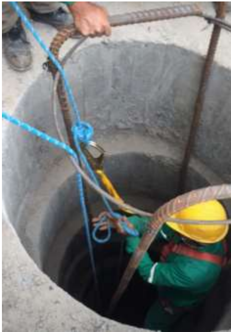
Fig. 10. Imagen de acceso a espacio confinado por medio de anclaje de nudo 8. ( Construcción de Caissons – YouTube, n.d. )
