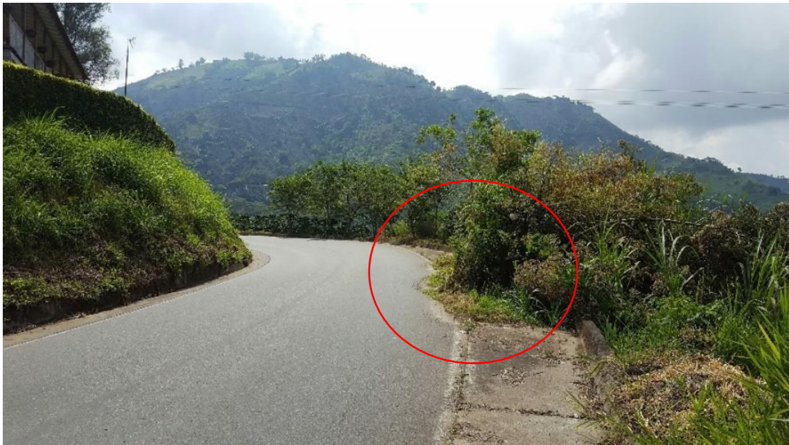
Figura 21. Fotografía proceso erosivo talud inferior en la vía Neira-Aranzazu K8+650.
