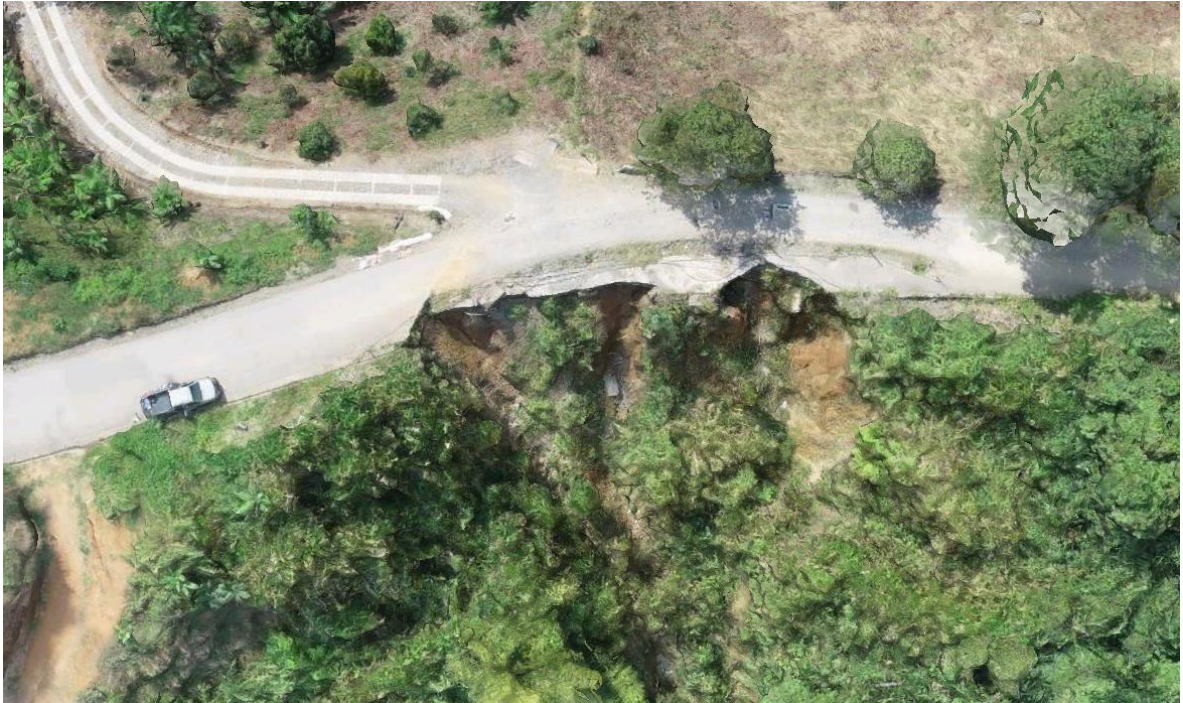
Figura 23. Fotografía aérea fallo de banca en la vía Asia-El Crucero-Las Margaritas, sector El Bosque, municipio de San José, departamento de Caldas.
