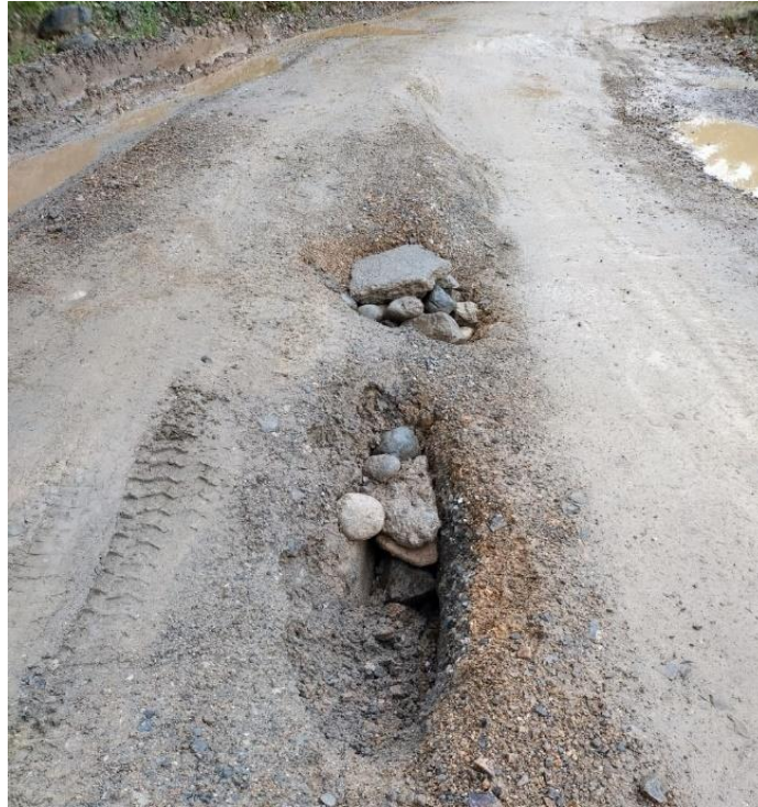
Figura 22. Fotografía sitio crítico por hundimiento de la estructura de rodadura en la vía Arma-La Pintada, sector Plan Del Oro, municipio de Aguadas, departamento de Caldas.
