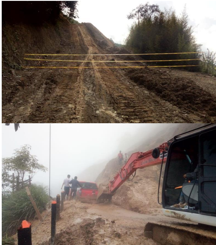
Figura 28. Fotografías sitio crítico en la vía Salamina-La Merced, sector El Faro, municipio de Salamina, departamento de Caldas.
