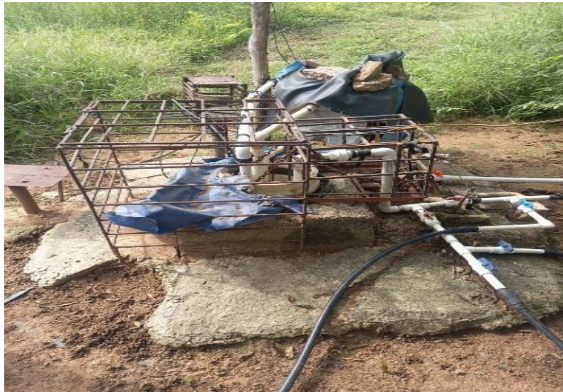
Figura 12.2: Pozo Subterráneo Vereda El Vallito
